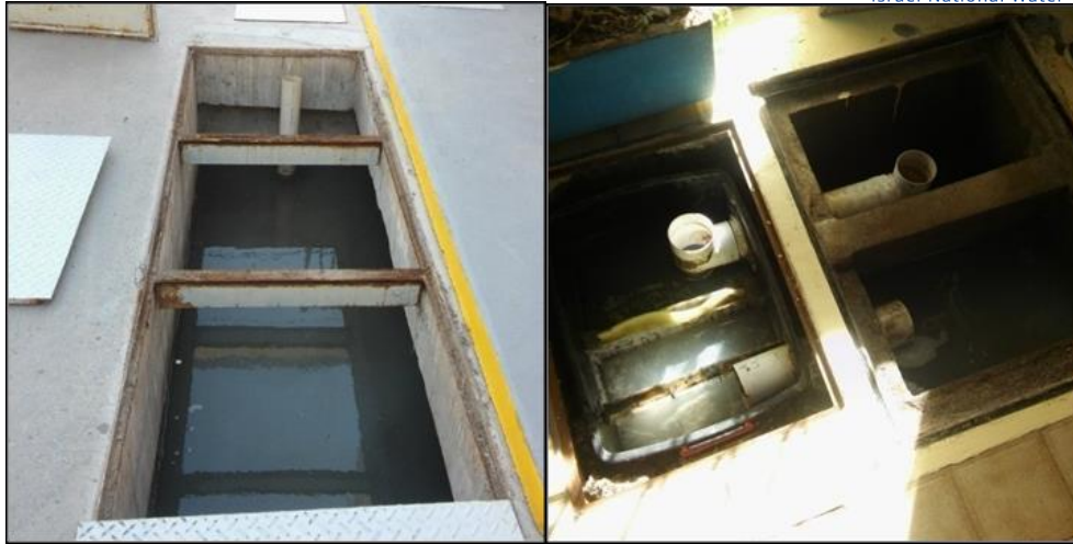
Ilustración 105 - Foto 1: Lavadero de vehículos. Foto 2: Lavadero de ropa
