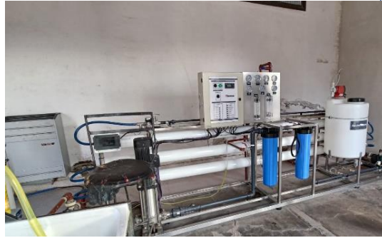
Ilustración 138 - Equipo de Ósmosis Inversa
