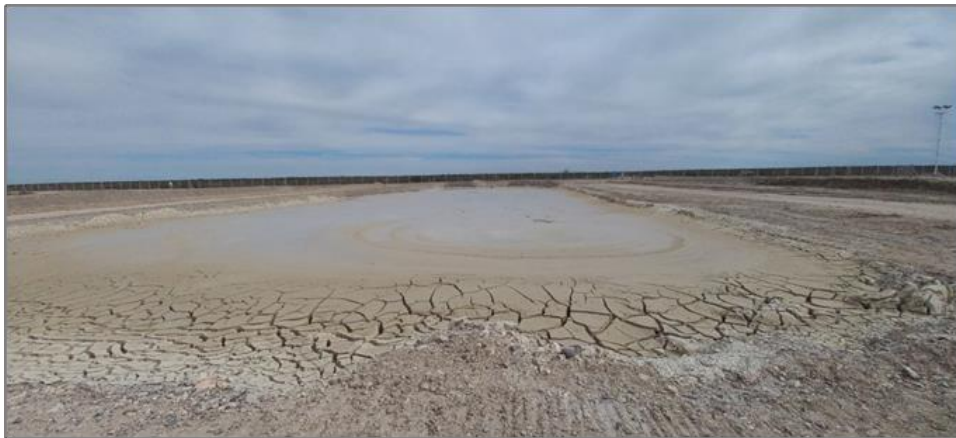
Ilustración 111- Pileta de secado de lodos de planta de lavado de arenas
