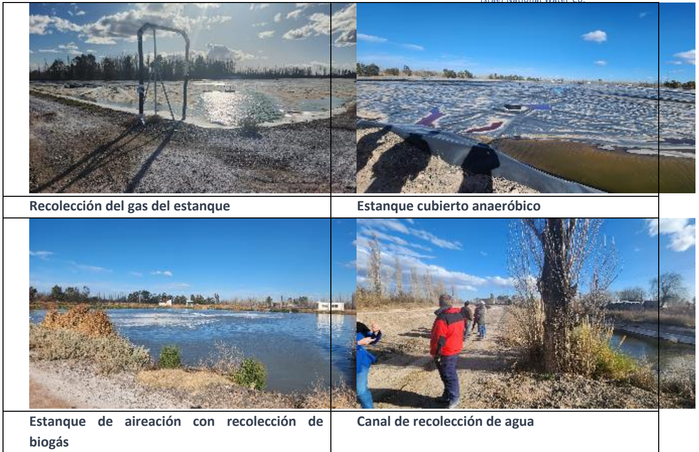
Ilustración 133 - Planta de tratamiento de aguas residuales de Cipolletti
