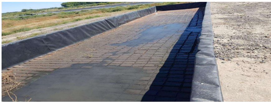
Ilustración 72 pileta de descarga de camión atmosférico
