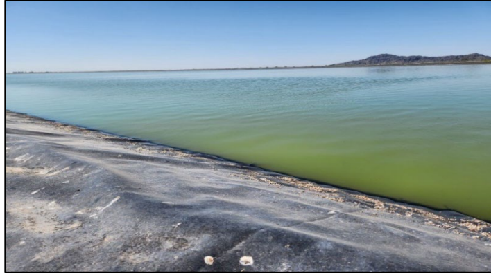
Figura 9-8: Presencia de algas en la etapa de oxidación de la planta Cerrillo Barboza
