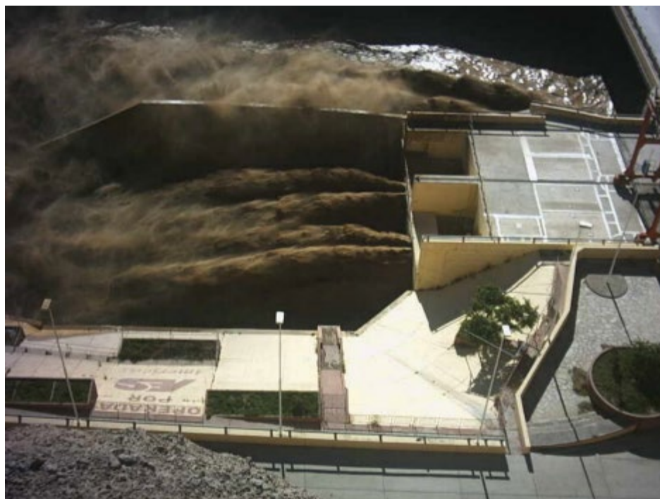
Figura 3-58: Foto de las válvulas de chorro hueco en funcionamiento (maniobra de limpieza de sedimentos) del Dique Quebrada de Ullum.
