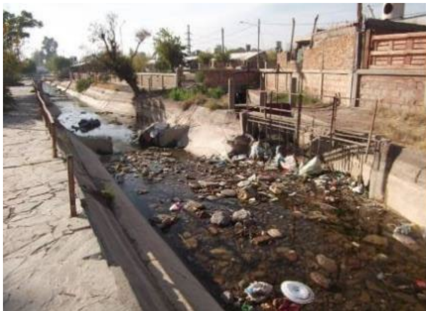
Figura 3-83: Foto Derivador Santa Lucía sobre el canal Benavidez, diseñado para derivar una dotación de riego de 1706 has. Dado que el canal atraviesa largos trayectos poblados la basura es un problema a solucionar. Existe un proyecto de entubado del canal Benavidez que permitirá, a futuro, eliminar el problema de basuras. gentileza PROSAP
