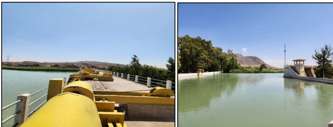
Figura 9-3: Derivador San Ignacio de la Rosa de agua de embalse para el abastecimiento de agua a la potabilizadora El Marquesado y para fines agrícolas.
