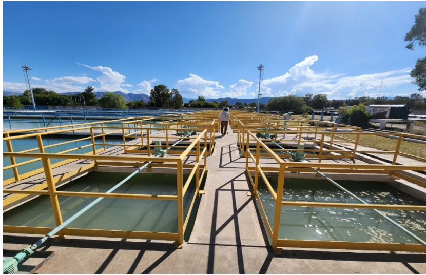
Figura 9-4: Floculadores en la planta potabilizadora de Marquesado
