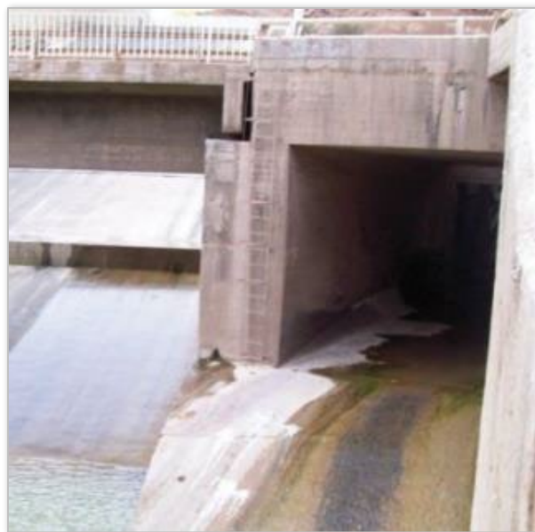
Figura 3-59: Foto salida del Descargador de Fondo. Manual de usuario sistema SARH- San Juan (Dölling et al 2021- PGICH- Proyecto SARH).
