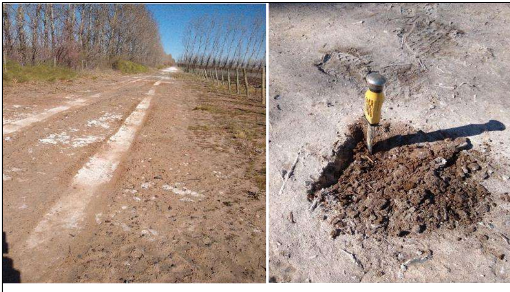
Figura 93. San Patricio del Chañar. Valle inferior del río Neuquén. a) Detalle de la foto anterior mostrando las eflorescencias salinas superficiales en el camino; b) en
